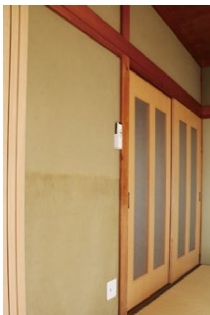
→ 浸水の跡を残す部屋
