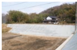
【中地内原川破堤箇所】
