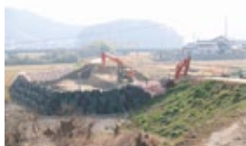
【東川面地内小田川破堤箇所】
