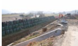
【本堀地内小田川破堤箇所】
