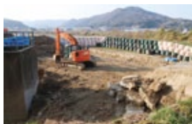
【江良地内小田川破堤箇所】
