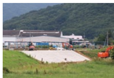
【本堀地内破堤箇所】
