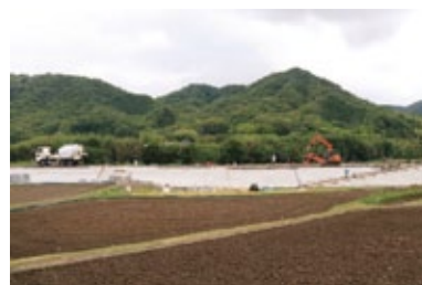
【東川面地内破堤箇所】
