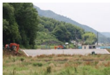
【江良地内破堤箇所】
