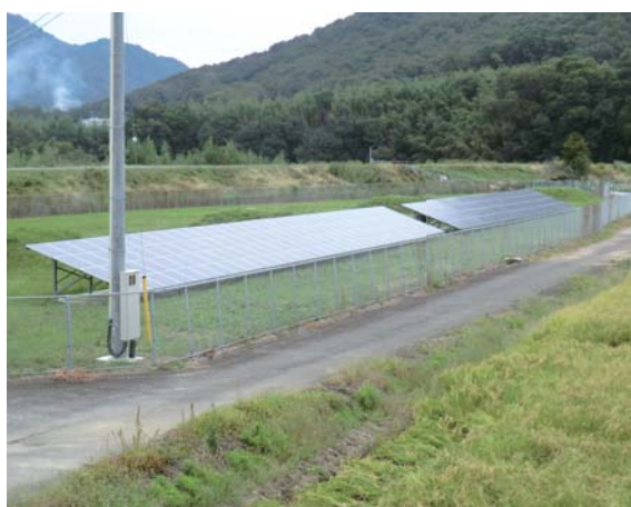
江良水源地の太陽光発電設備
