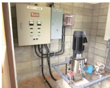
日置谷加圧ポンプ場 ポンプ設備
