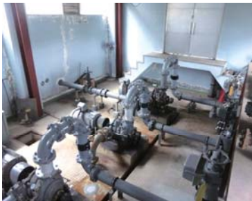
東川面浄水場 送水ポンプ
