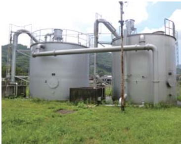
東川面浄水場 急速ろ過機
