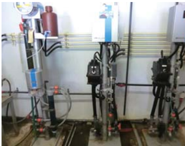
東川面浄水場 水質計測器
