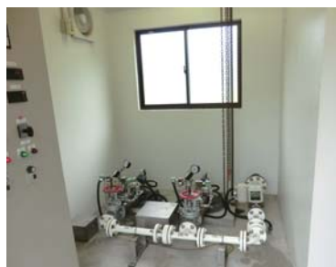
上高末加圧ポンプ場 ポンプ設備
