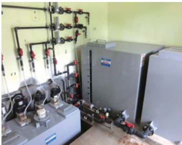
東川面浄水場 塩素滅菌設備
