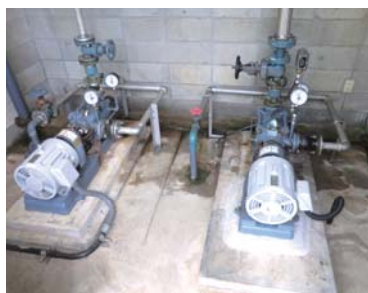
大唐田加圧ポンプ場 ポンプ設備
