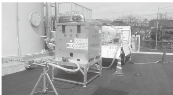
災害時の給水装置
