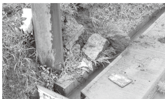
こわれた水路
