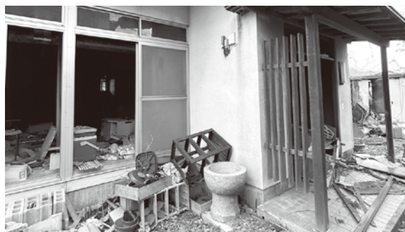
管理されていない空家の状況
