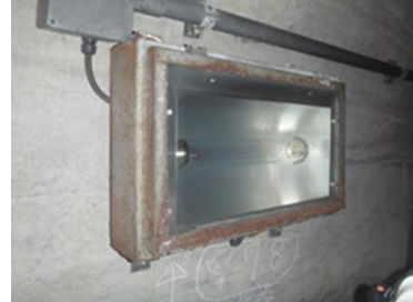
照明器具の腐食（平成25年度点検）
