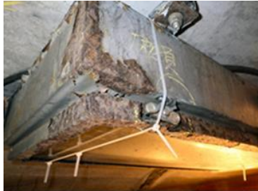
照明器具の腐食（平成30年度点検）
