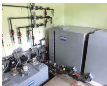
東川面浄水場 塩素滅菌設備
