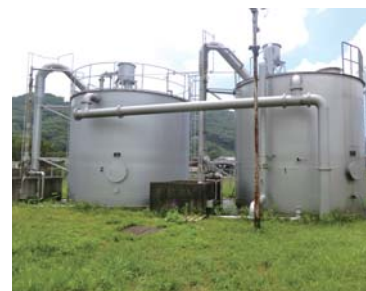
東川面浄水場 急速ろ過機
