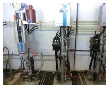
東川面浄水場 水質計測器
