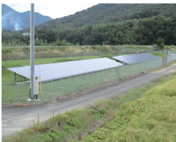
江良水源地の太陽光発電設備
