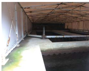
東川面浄水場 沈澱池
