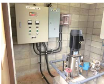
日置谷加圧ポンプ場 ポンプ設備
