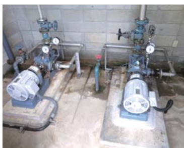
大唐田加圧ポンプ場 ポンプ設備
