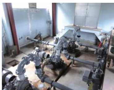
東川面浄水場 送水ポンプ
