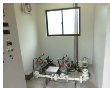
上高末加圧ポンプ場 ポンプ設備
