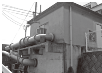
機能強化される元町排水ポンプ
