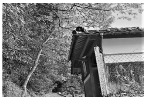
建物に覆いかぶさってくる危険木
