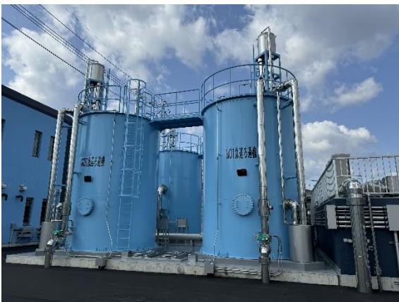
急速ろ過機（東川面浄水場）
