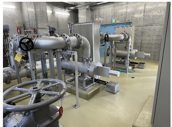
紫外線殺菌処理設備（東川面浄水場）
