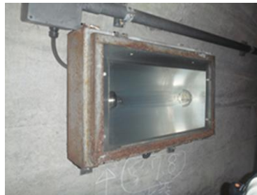
照明器具の腐食（平成25年度点検）
