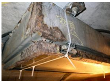
照明器具の腐食（平成30年度点検）
