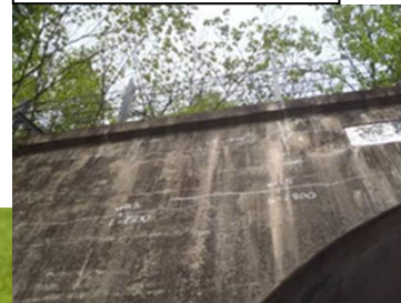
水平方向ひび割れ（終点側）
